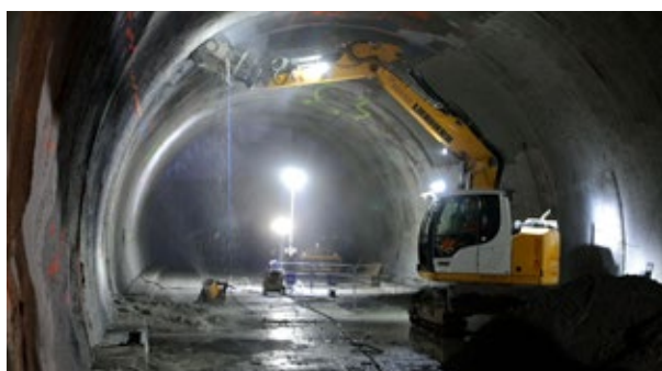
▲ Les travaux de remise en état se sont déroulés jour et nuit pour permettre la réouverture en novembre.
