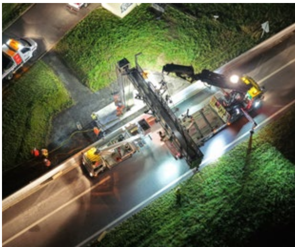
▲ Des potences ont également été posées sur les entrées de l'aire bidirectionnelle de Bonneville.
