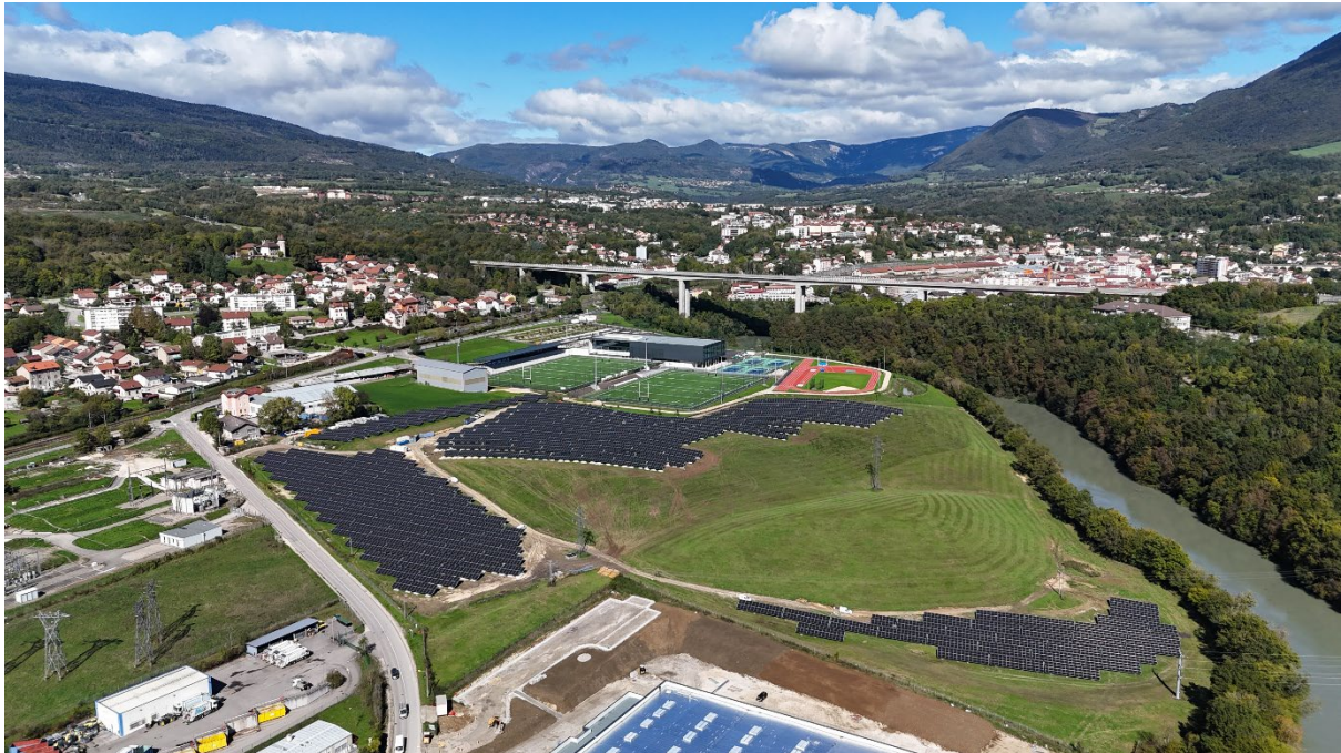
Centrale photovoltaïque Solarhona de Valsère au premier plan, avec le viaduc ATMB de Bellegarde en fond
