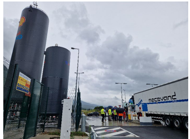
Station GNL Shell à Bonneville ©ATMB
